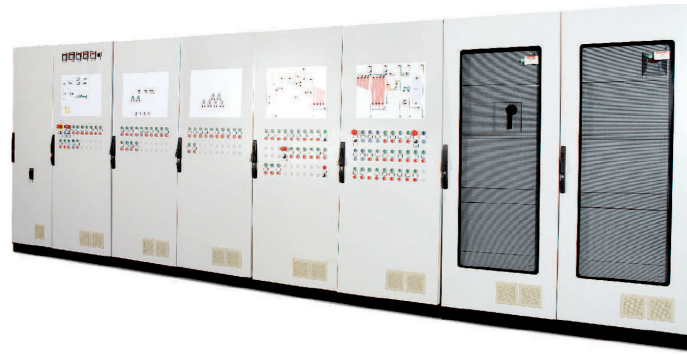
Panneau de configuration des commandes MCC MCC Command Control Panel
